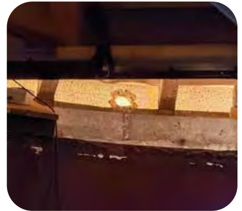
Durch dieses kleine Loch sollen die Mauersegler ins Turminnere zu ihren Nistplätzen gelangen.
